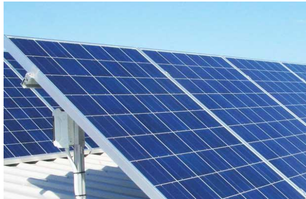
Σχήμα 6. Φωτοβολταϊκά ηλιακά πάνελ
